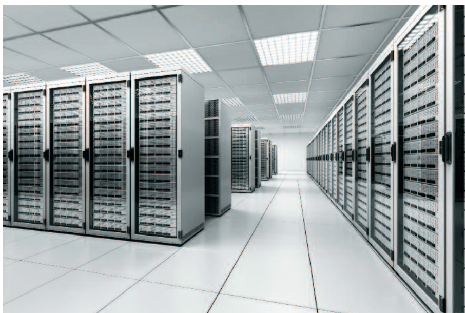
Exemple d'utilisation: Local informatique
